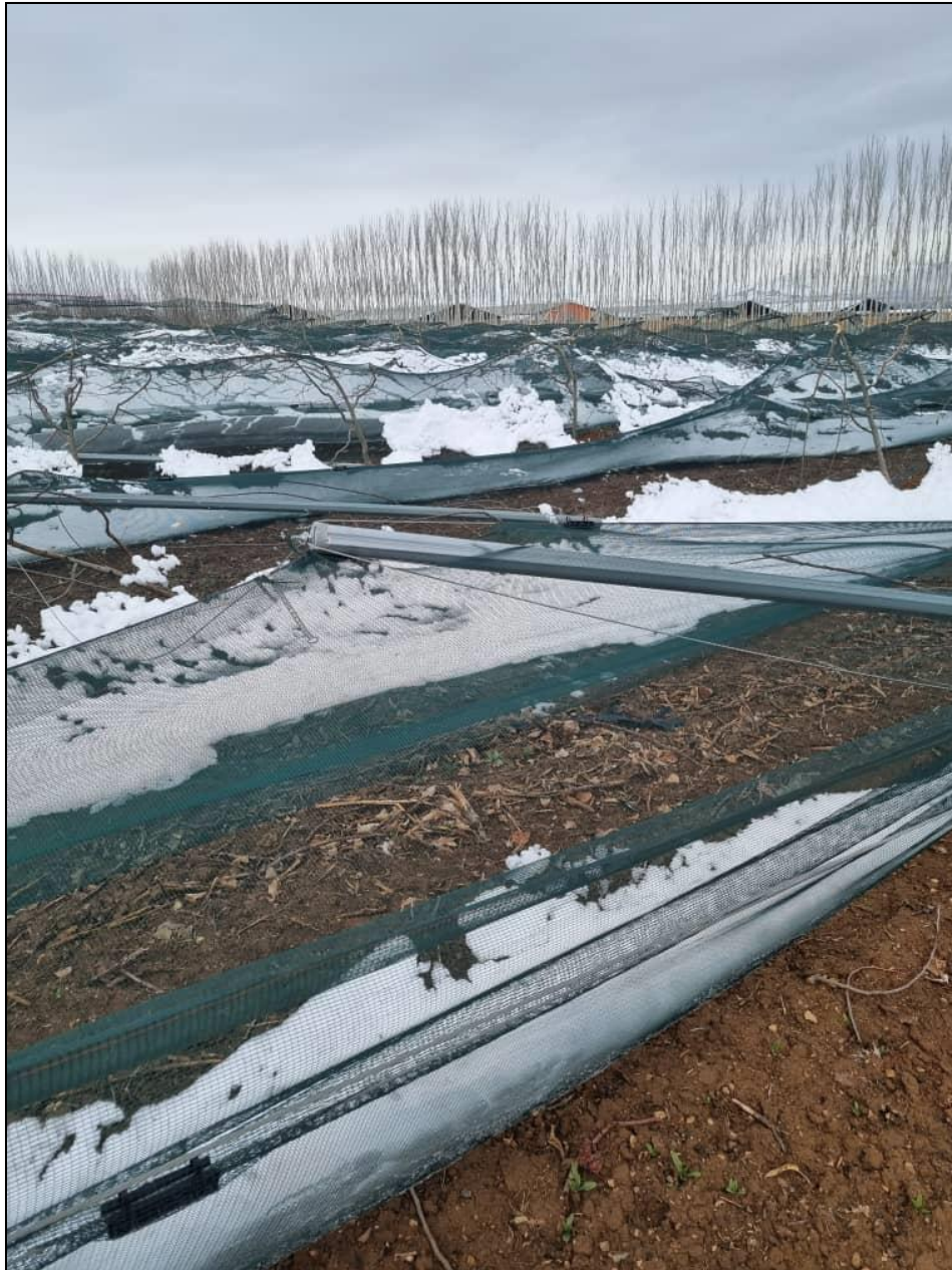
شکل ۴۴: تخریب سازه ناشی از عدم تحمل به بار برف (عکس از نگارنده)
